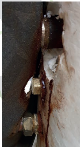
Rézcsővel „kötött” acéltartály csatlakozásainak elektrokémiai korróziója 16 hónap üzemeltetés után, a csatlakozók hegesztési varratainál már első üzemében belül szivárgást okozhat.
